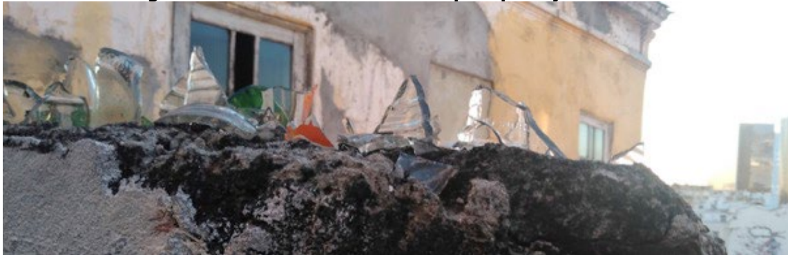
Figura 11: Cacos de vidro no muro para proteção da casa.
