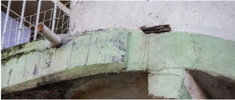
Figura 12: "Puxadinho" denunciado pelo revestimento.
