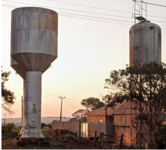
Figura 9: Rede de captação de poço artesiano
