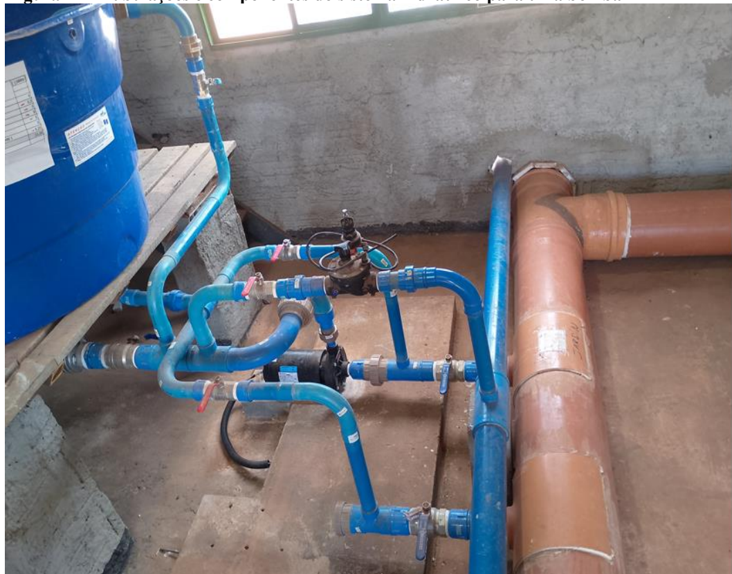
Figura 12 – Tubulações e componentes do sistema hidráulico para uma bomba
