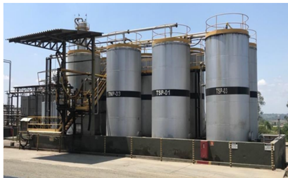
Figura 5 – Tanques de armazenamento do OLUC aprovado para rerrefino
