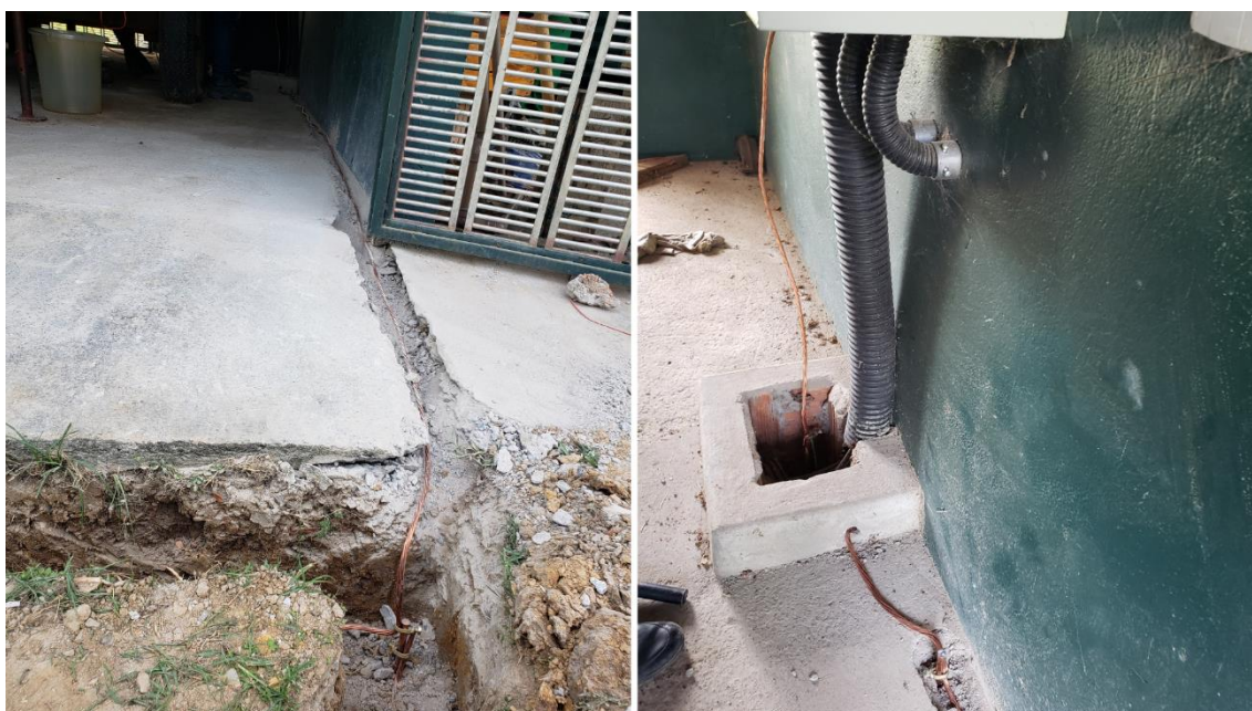
Figura 11: Conexão da malha de terra ao QDG
