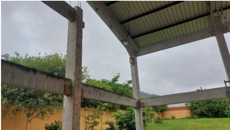
Figura 7. Viga de concreto armado do cintoamento superior caída Fonte. Acervo do Grupo PET Engenharia Civil da UFSM (2024)
