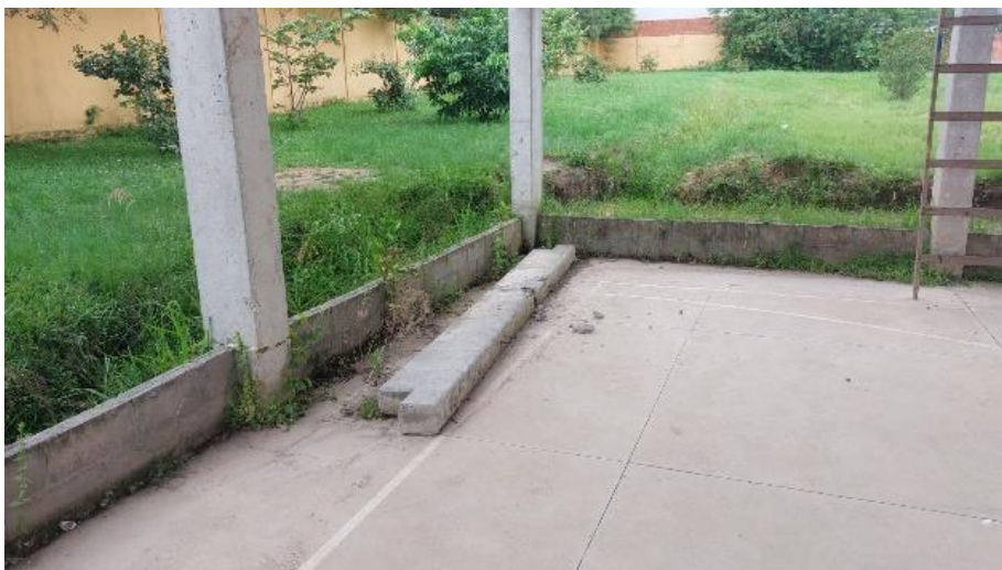
Figura 8. Viga de concreto armado do cintoamento superior caída Fonte. Acervo do Grupo PET Engenharia Civil da UFSM (2024)
