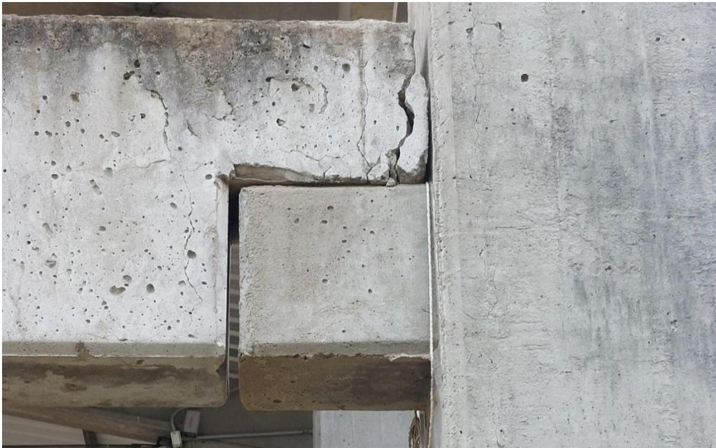
Figura 15. Danos no dente da viga por falha de montagem Fonte. Acervo do Grupo PET Engenharia Civil da UFSM (2024)
