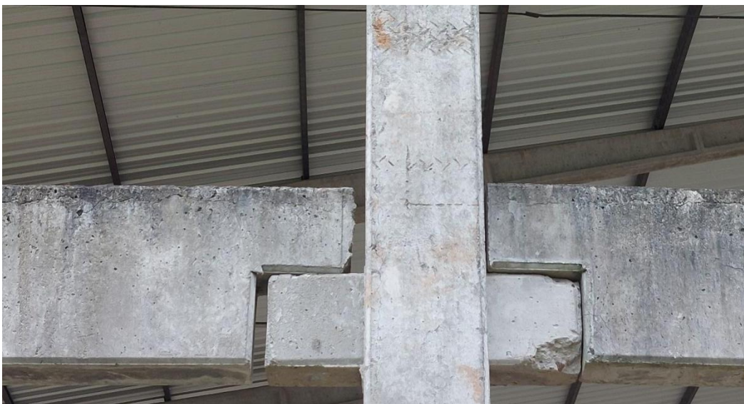
Figura 16. Desalinhamentos nas peças por falha de montagem Fonte. Acervo do Grupo PET Engenharia Civil da UFSM (2024)
