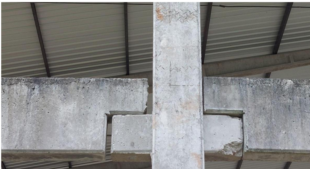
Figura 16. Desalinhamentos nas peças por falha de montagem
