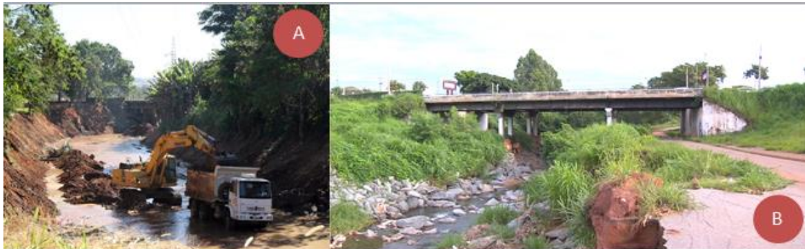
Figura 7: Obras de engenharia e degradações nas margens do Córrego Cascavel.
