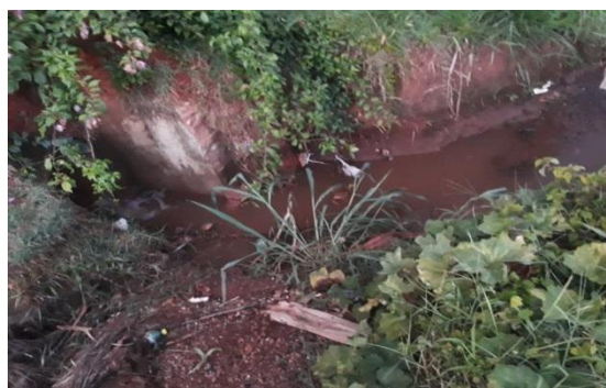
Figura 8. Trecho do córrego com resíduos diversos, ruínas de uma galeria e margens degradadas.
