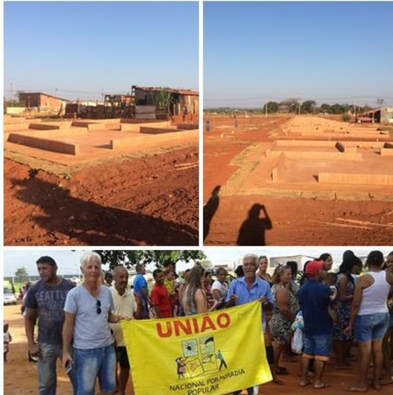
Figura 3: Imagens do início da construção das casas, Jardim das Primaveras, 2019 Fonte: AUTOR(A), 2019.
