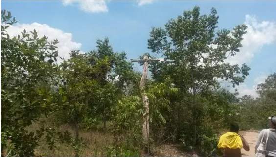
Imagem: 13: Vista do poste antigo de energia elétrica. Foto: O autor (2016).
