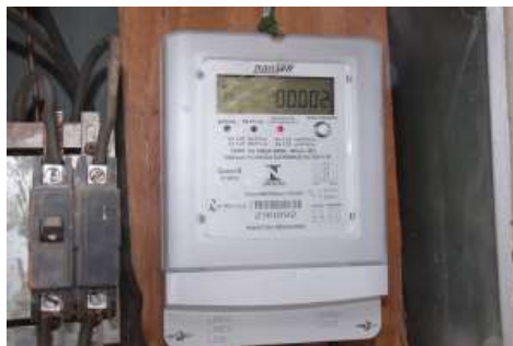
Novo medidor de energia que alimenta a rede com energia gerada a partir do sol
