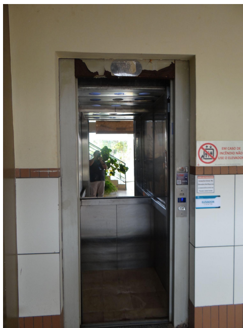
Figura 2. Elevador instalado no Bloco C da Unidade II do Campus de Aquidauana
