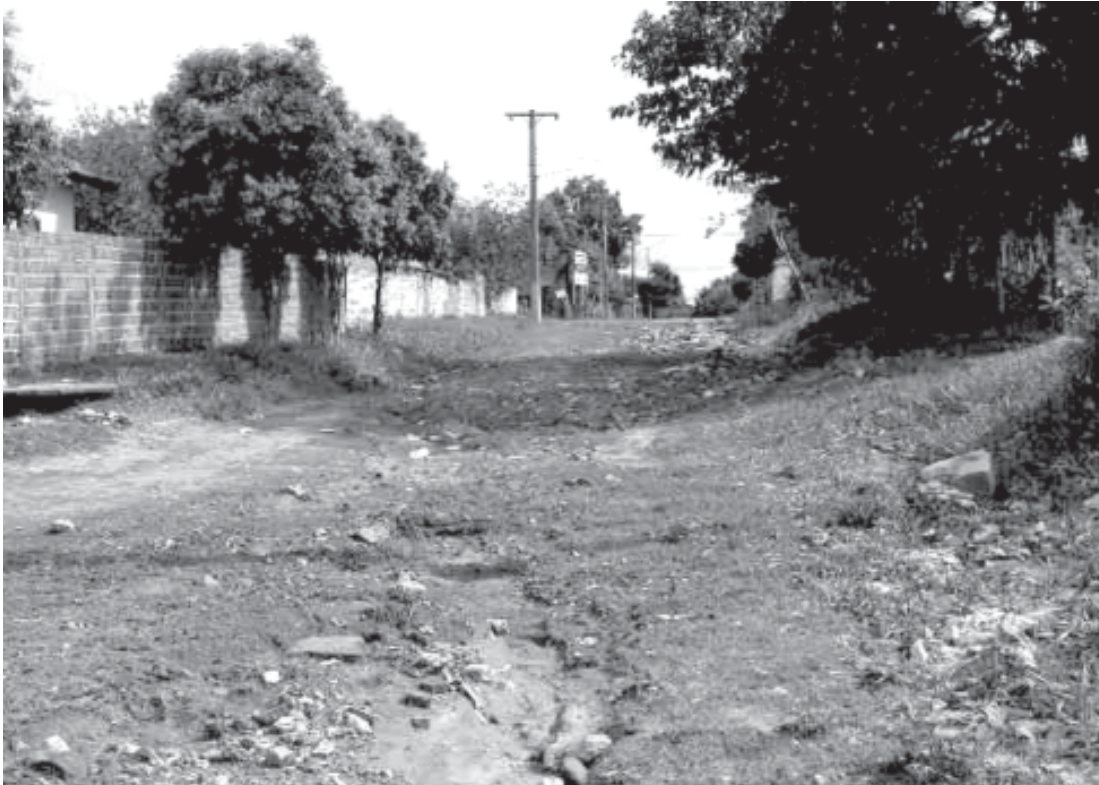
Figura 05 - Vertente da margem esquerda do canal do córrego J. Dias Erosão remotante sobre leito de arruamento urbano, cuja cabeceira aproxima-se do divisor de águas na altura da R. Pandiá Calógeras/ Vila Paraíso.
