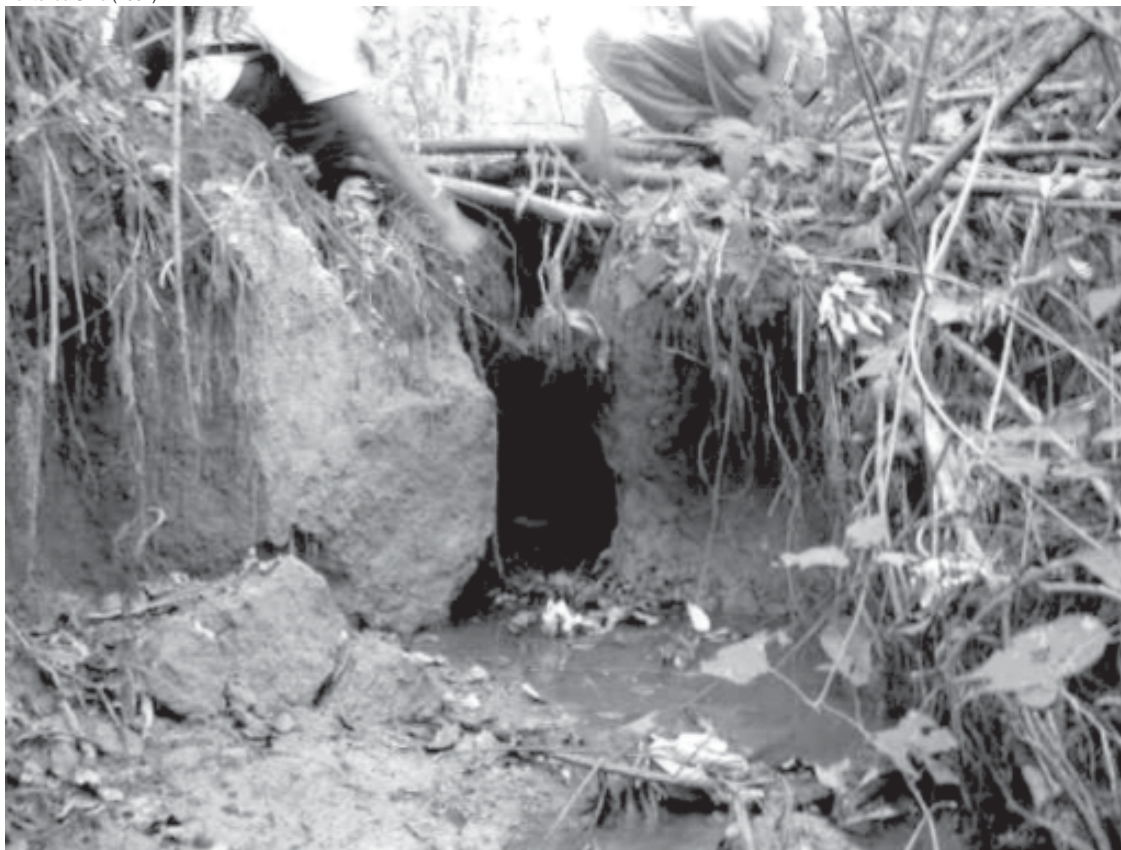
Córrego Pedra Preta - acúmulo de dejetos
