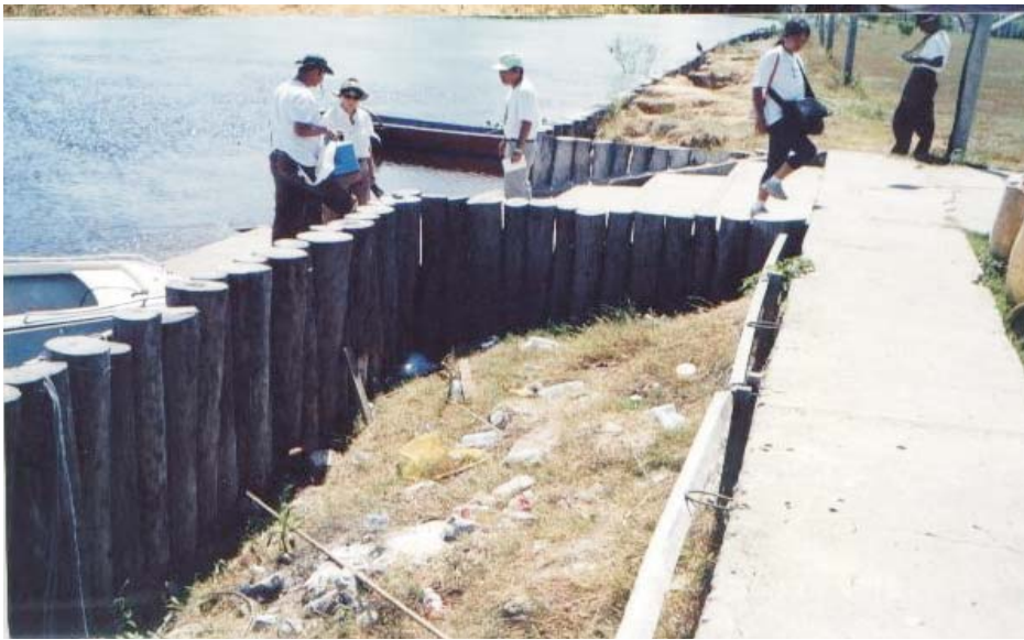
Figura 2. Descaracterização da área de Área de Preservação Permanente (Mata Ciliar) ao longo do Canal do Rio Negro-MS.
