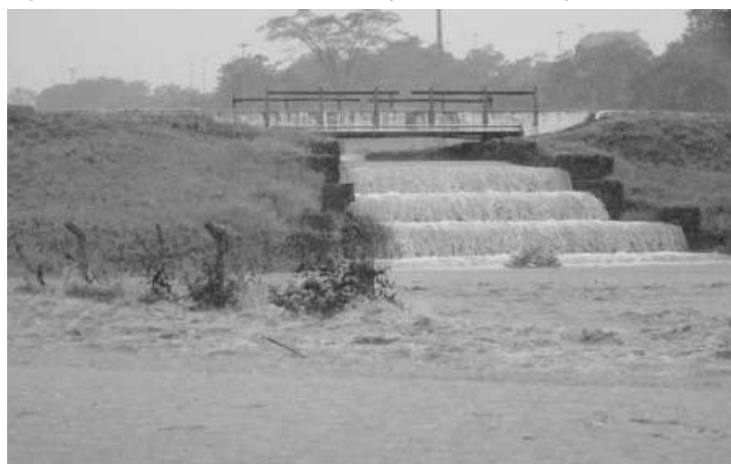
Figura: 8 - Danos advindos da precipitação intensa na Região Urbana Prosa
