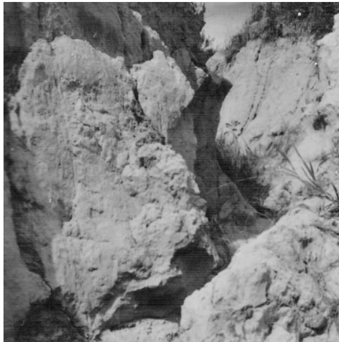
Figura 2. Solapamento da base com deslocamento da massa do talude.
