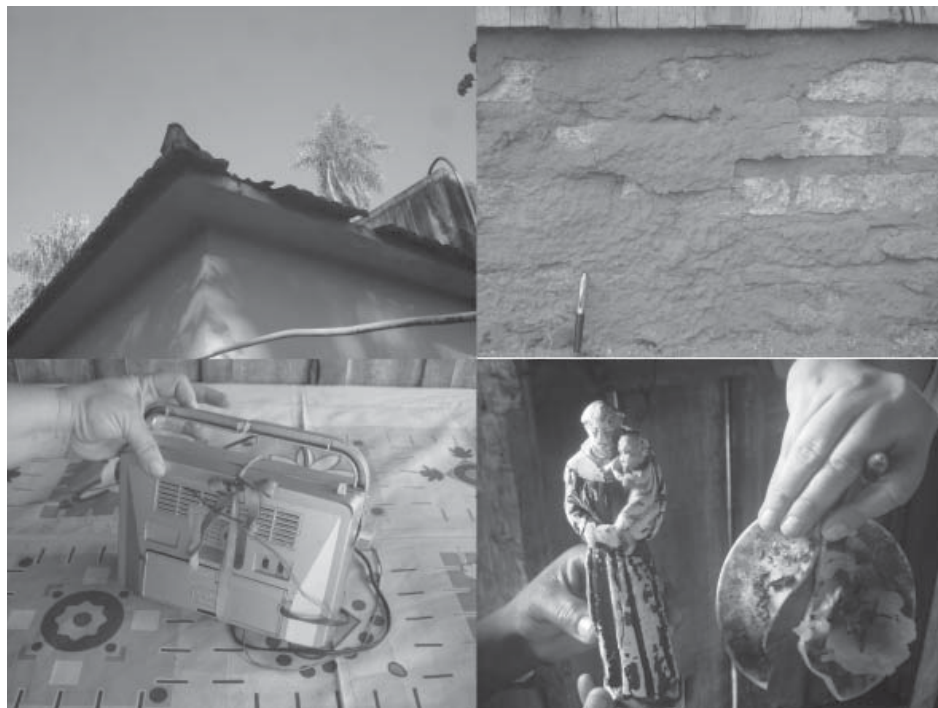
Figura 6. Danos causados pelo sismo de 2009 de Coxim-MS com intensidade VI na Escala de Intensidade Mercalli Modificada. Nota-se quedas e quebras de objetos, reboco e telhas e trincas em paredes. Local: Fazenda Santo Antônio, região da Nhecolândia, na Bacia do Pantanal (área epicentral).
