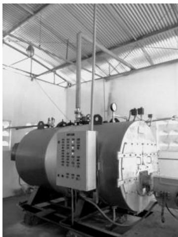
Fig. 1. Caldeira flamotubular alimentada com gás natural, marca Tange, modelo TG 80/10. As emissões atmosféricas foram coletadas em orifício localizado no duto exaustor do equipamento
