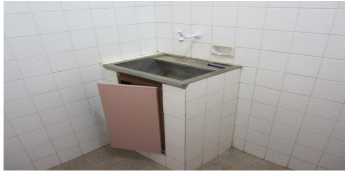
Figura 1 - Pia de dispensação inadequada de resíduos químicos.
